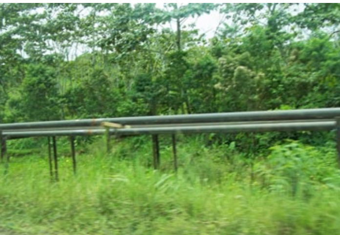
Foto2: Sistemas de transporte expuestos en la superficie con procesos de corrosión.
