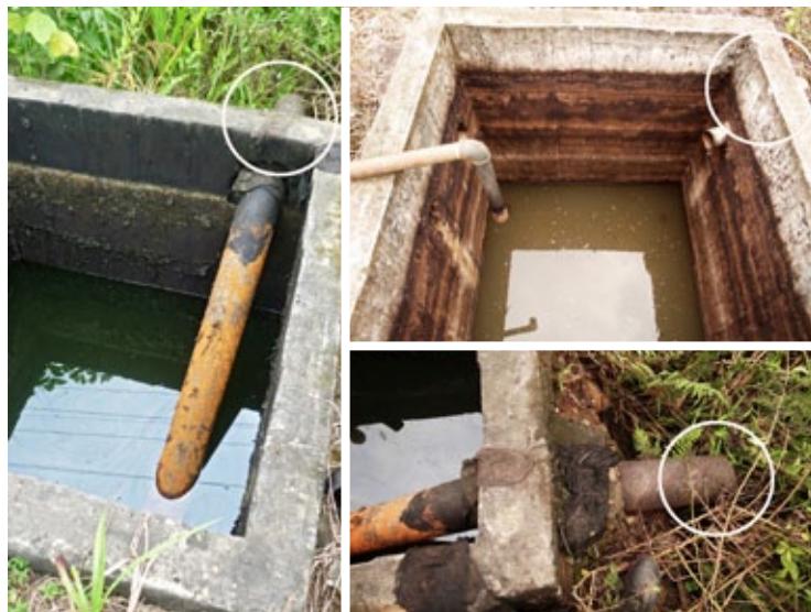
Drenajes en pozo Atacapi 2 (Dureno)
