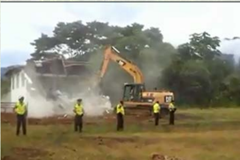
Derrocamiento de la Iglesia del Barrio de San Marcos y operativo policial desplegado (Fotografía: CASCOMI)
