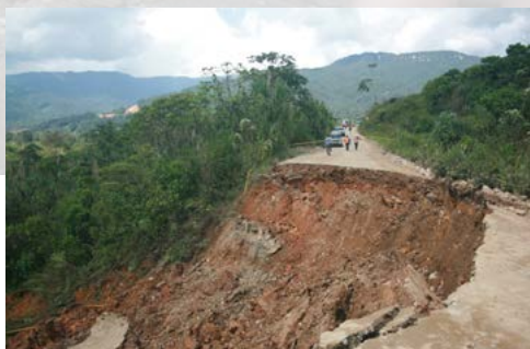
Derrumbe de Carretera por constante paso de transporte pesado de la empresa minera en la Vía El Cóndor parroquia Tundayme (Fotografía: Equipo de trabajo)
