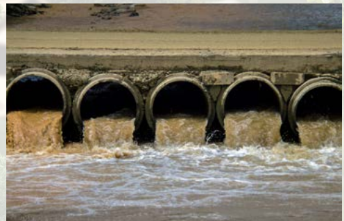
Río Tundayme, trabajos realizados por la empresa minera Ecuacorriente S.A. para dar paso a sus camiones y volquetas, estos trabajos sobre el lecho del río generaron graves inundaciones en las fincas aledañas (Fotografía: Omar Ordoñez)
