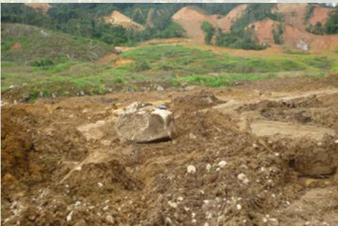
Remoción de tierras, deforestación y retirada de la capa vegetal de la montaña (Fotografía: Equipo de trabajo)
