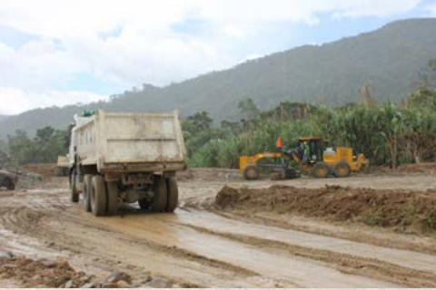
Vía El Cóndor en mal estado por el tránsito constante de camiones, volquetas y maquinaria pesada (Fotografía: Luz Estrella)
