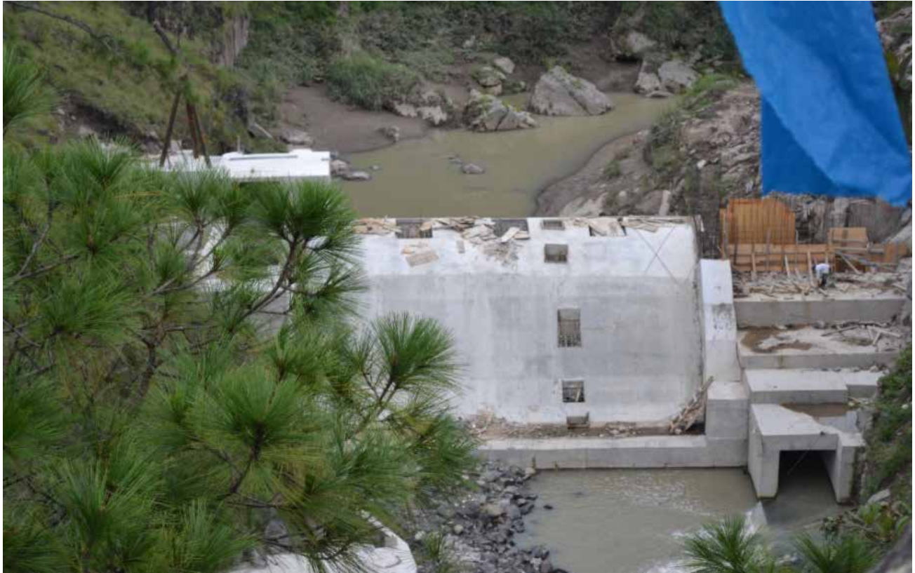
Construcción de presa hidroeléctrica Corral de Piedras, la concesión de este bien común es por 20 años a la empresa Energía de Occidente ENERCO.
