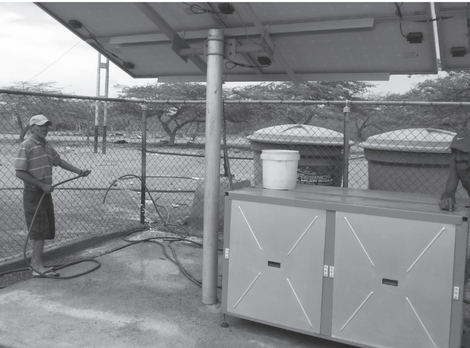
Sistema fotovoltaico de potabilización de aguas en Paraguaná
