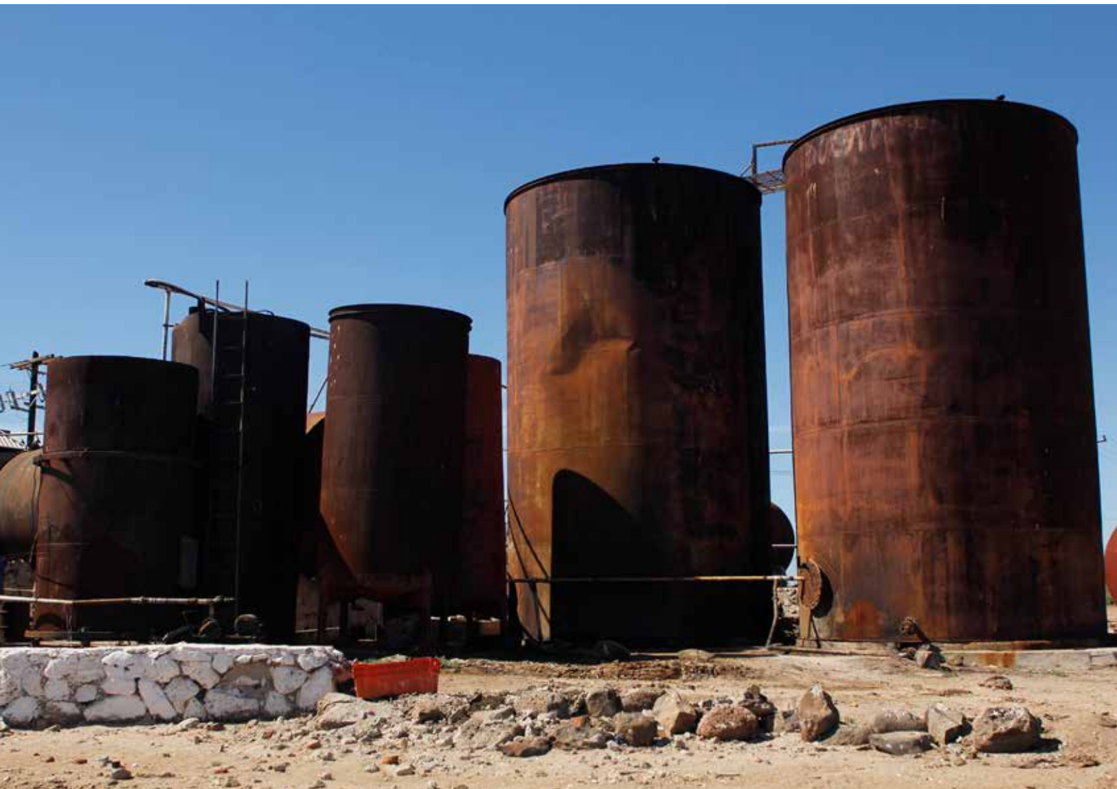
El abandono y el deterioro del supuesto progreso industrial. Foto: Jerónimo Palomares
